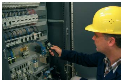
Detaillierte Infrarottemperaturmessung an einer elektrischen Steuerung mit Hilfe der eingebauten Scharfpunktoptik des optris LS LT im 1 Millimeterbereich
