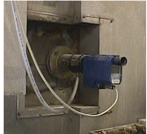
Strahlungspyrometer mit Armaturen in MVA
